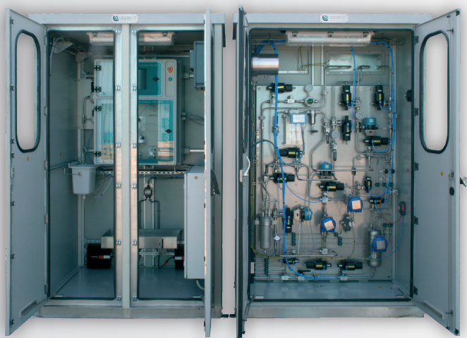
Анализаторный шкаф с различными модулями подготовки пробы
